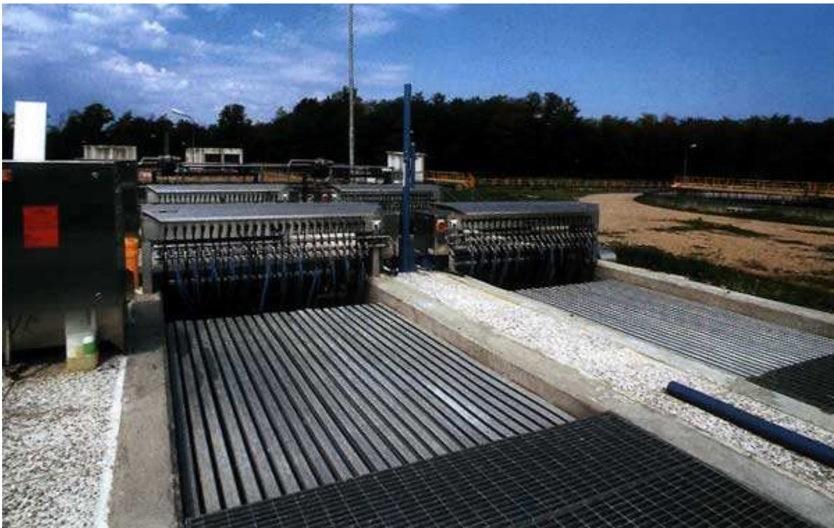
L'impianto a raggi UV per abbattere la carica batterica.
